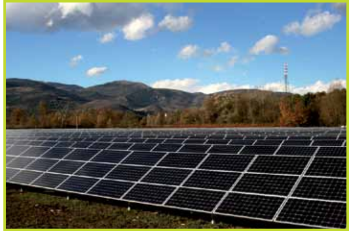
I 50 impianti realizzati da CEV a Popoli (PE), per 50 Comuni Soci.
